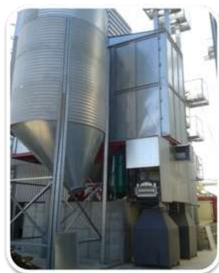
Doa generatoare de aer cald ecoHORNET 300 KW montate la un uscator de cereale Silos Cordoba, Adunatii Copaceni, jud. Giurgiu
