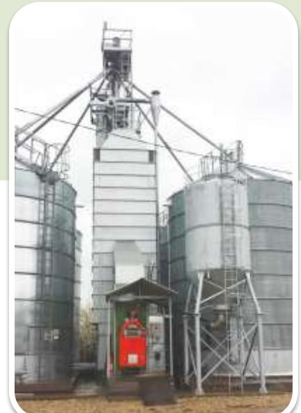
Arzatorul ecoHORNET AHP700 a inlocuit injectorul pe motorina la un generator de aer cald ce deserveste un uscator de cereale. (Targul Jiu, Gorj)
